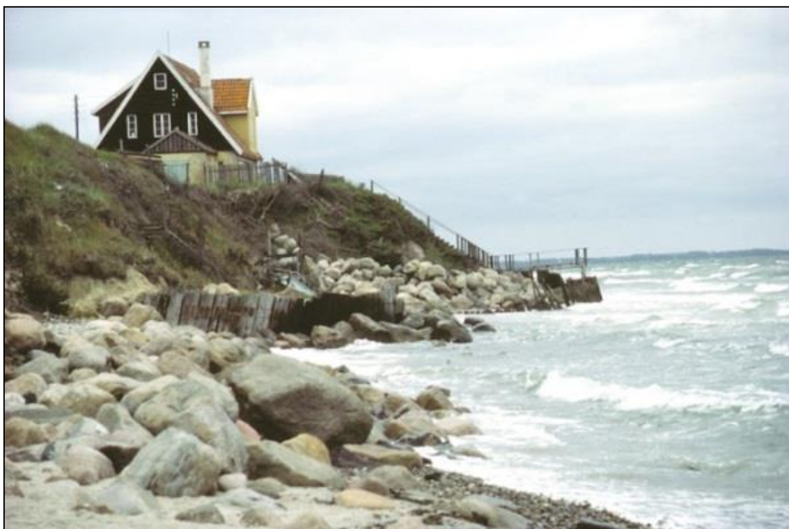
Figur 2.27 Eksempel på virkning af skræntfodsbeskyttelse, stranden er forsvundet. Liseleje før det "nye" bølgebryderprojekt.
